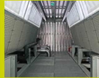
Technologie de refroidissement par air.
