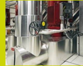
Pompes à débit variable.
